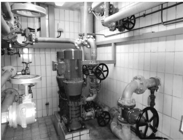
Das Innere der neuen Pumpenanlage
